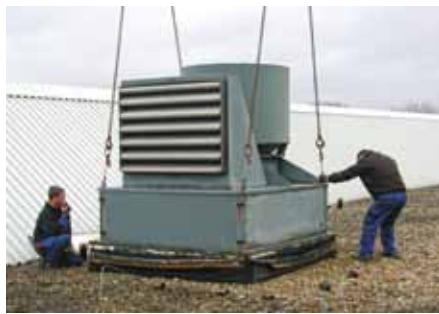
Der alte DWR wird zur Demontage vorsichtig vom Sockel gelöst und komplett abgehoben.
